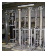
オゾン・紫外線処理装置
