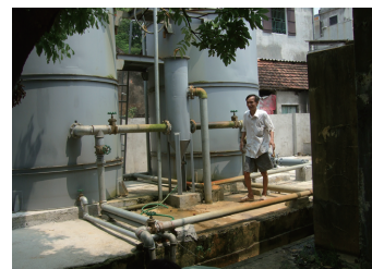
図 4 ベトナムに設置した水処理施設
